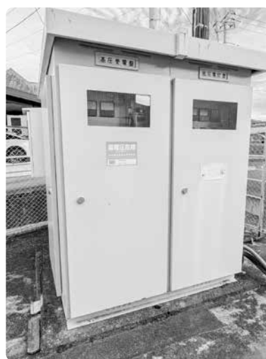
キュービクル 高圧の電気を低い電圧に変える装置
