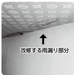
雨漏りで修繕を待つ民俗資料館
