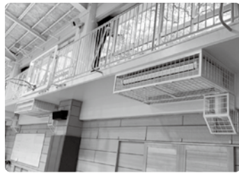
他校の体育館に設置されたエアコン室内機 (写真はメーカー提供)
