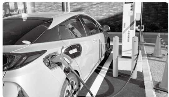
整備された電気自動車用急速充電器
