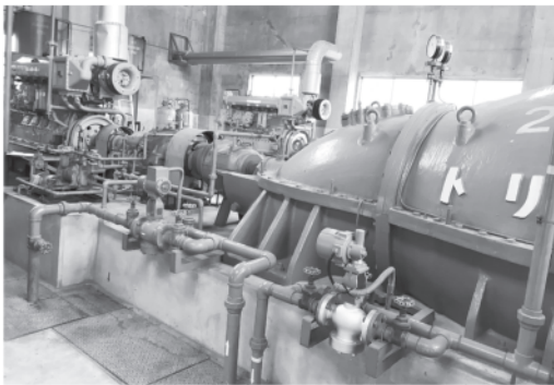
排水機場内部 大型エンジン・減速機・ポンプが並び
