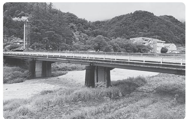
補修予定の開柳橋
