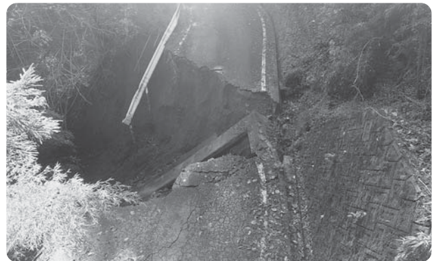
台風19号で崩落した林道富士見山線
