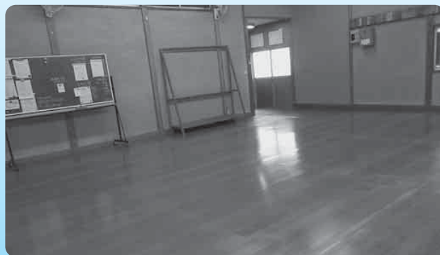
床改修が必要な殿原スポーツ公園弓道場
