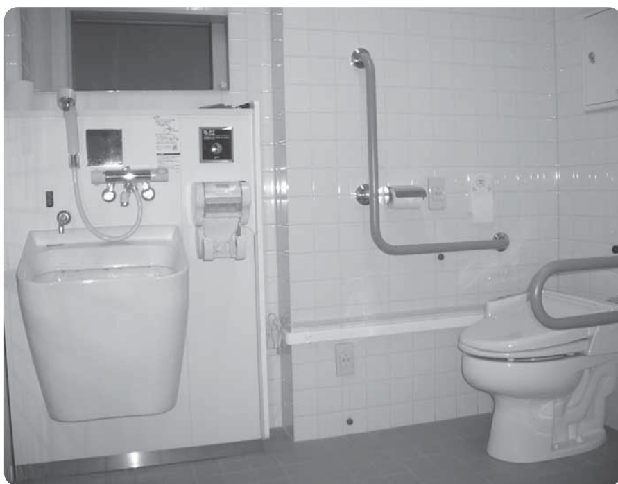
保健福祉支援センター内多目的トイレ
