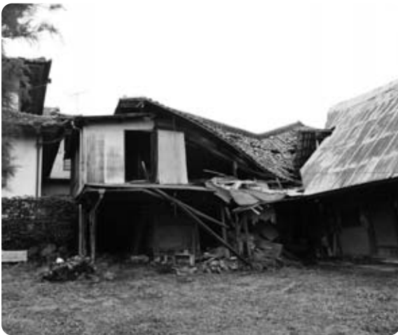
倒壊の危険性が高い空き家
