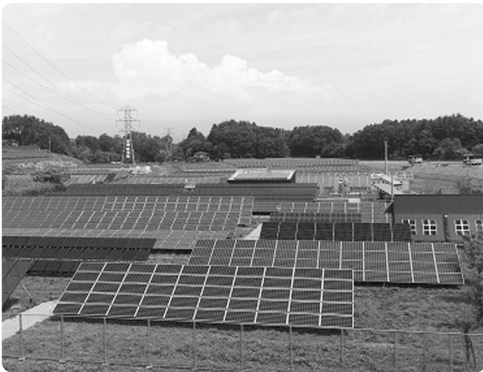
北杜市の太陽光発電設備
