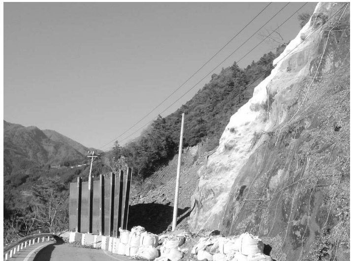
十谷線の崩落現場
