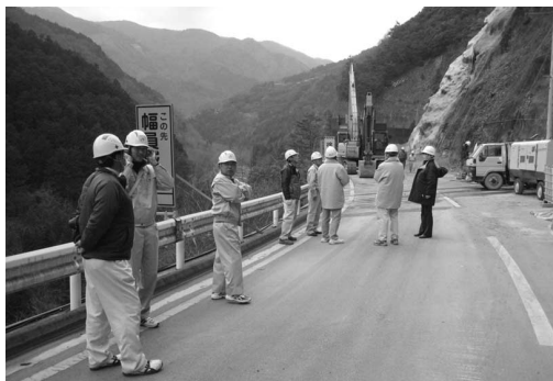
十谷線の崩落現場を視察
