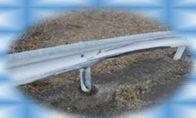
ガードレールの損傷
