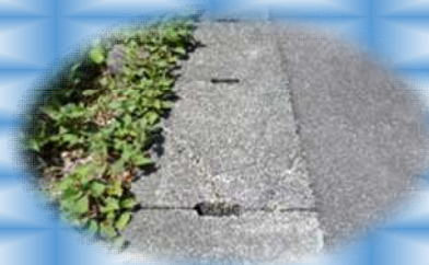
側溝蓋の割れ
