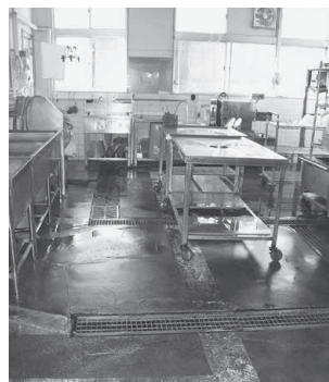
▲ウェット方式の給食室
