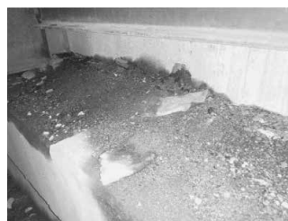
橋の端部の土砂堆積
