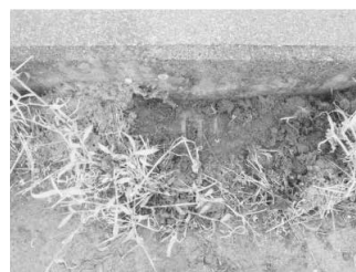
排水ますの土砂詰まり
