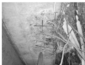
コンクリート床版の鉄筋露出
