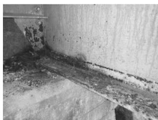
鋼桁の塗装劣化
