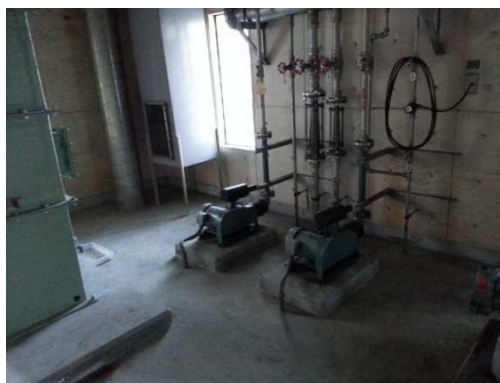
箱原浄化センター内 ブロー室
