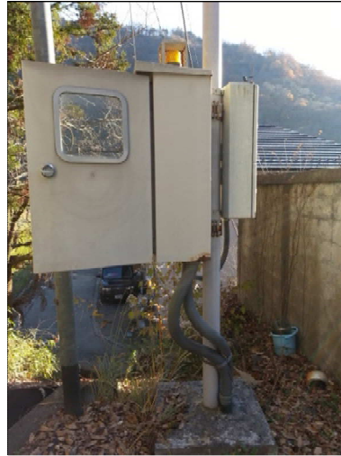
中継ポンプ設備
