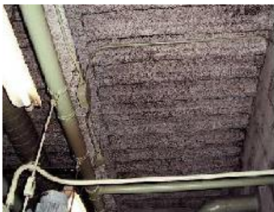
石綿含有吹付けロックウール
