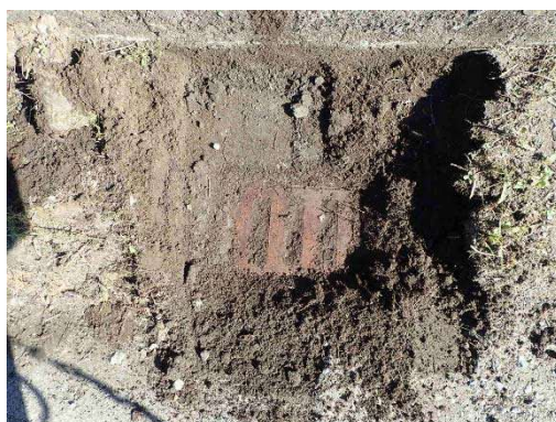
排水ますの土砂詰り
