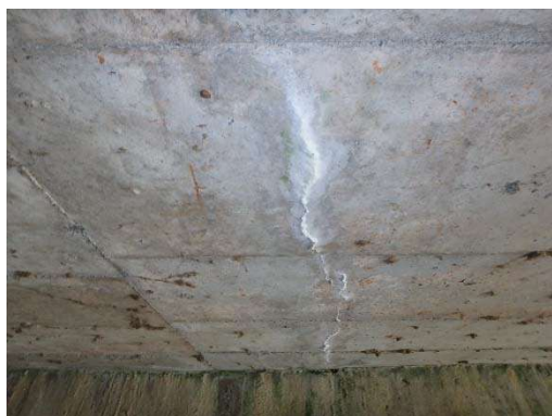
コンクリート床版のひびわれ
