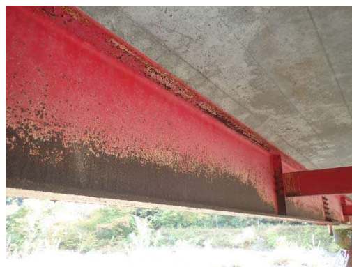
鋼桁の塗装劣化
