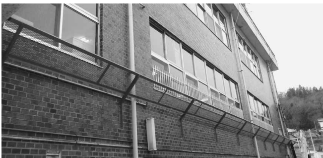
▲昭和43年竣工の役場分庁舎（旧鯉沢町役場） （外壁タイル落下により防護柵を設置している）
